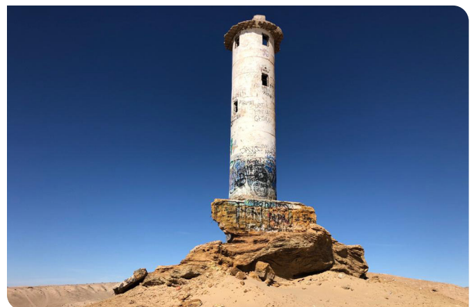
Uma fonte de luz temporária foi instalada fora do local quando o antigo Farol Machorro foi considerado um risco à segurança.
